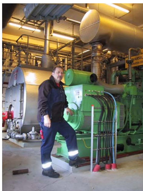
Bilde 3. Motor for kraftproduksjon og gassfyrte kjele for biogass ved Mjøsøanlegget, Lillehammer.
