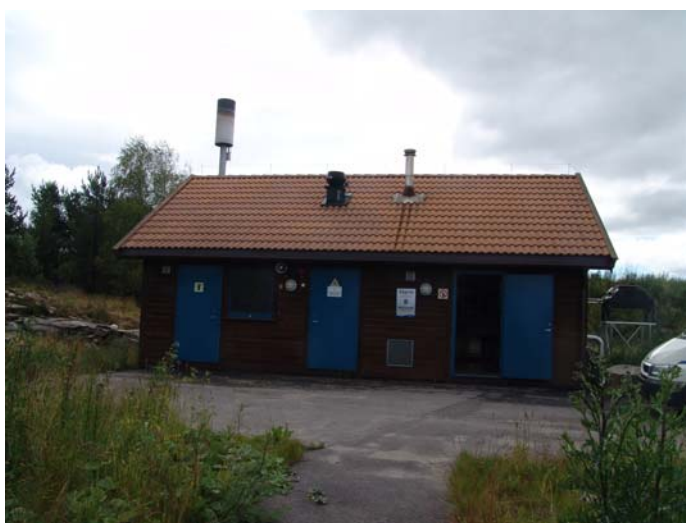
Bilde 4. Anlegg for oppsamling av deponigass fra Movars deponi utenfor Moss. Mulig utnyttelse av gassen blir vurdert.
