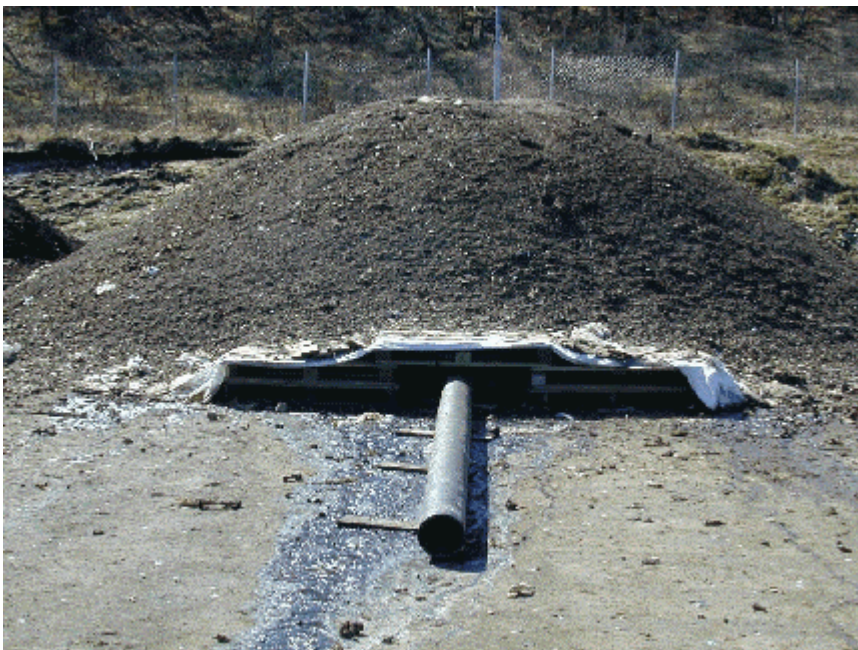
Bilde 5: Storranke under bygging. Pallekanal med lufterør inni. Råkomposten legges inn fra begge sider.
