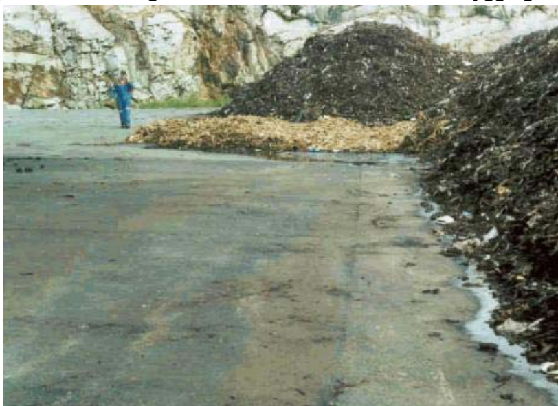
Bilde 3: Ranke under bygging. Ranken legges på en madrass av grov struktur.
