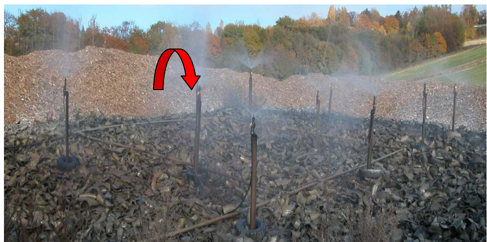
Figur 5 : Bilde fra Kolons forsøksanlegg i Lier hvor spiraldyser benyttes for å spre vannet over filterflaten. Legg merke til at det dannes en tåkesky av vannpartikler rundt dysespissene. Den røde pilen peker på én av dysespissene.
