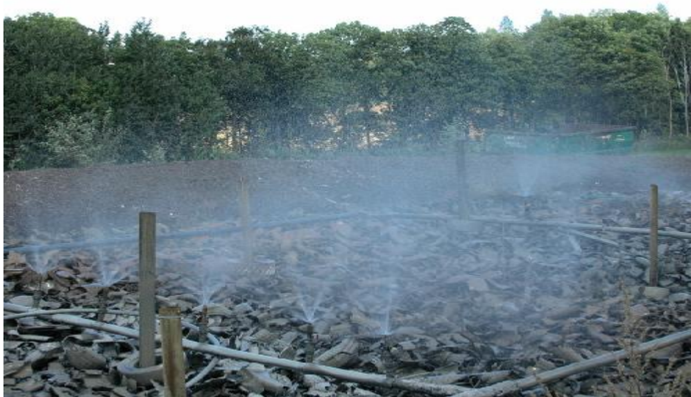
Figur 17 : Dekk-klippbassenget på Lierfyllingen i drift. Spiraldysene forstøver vannet meget godt og sikrer full oksygentilgang til både vannet og filtermediet.
