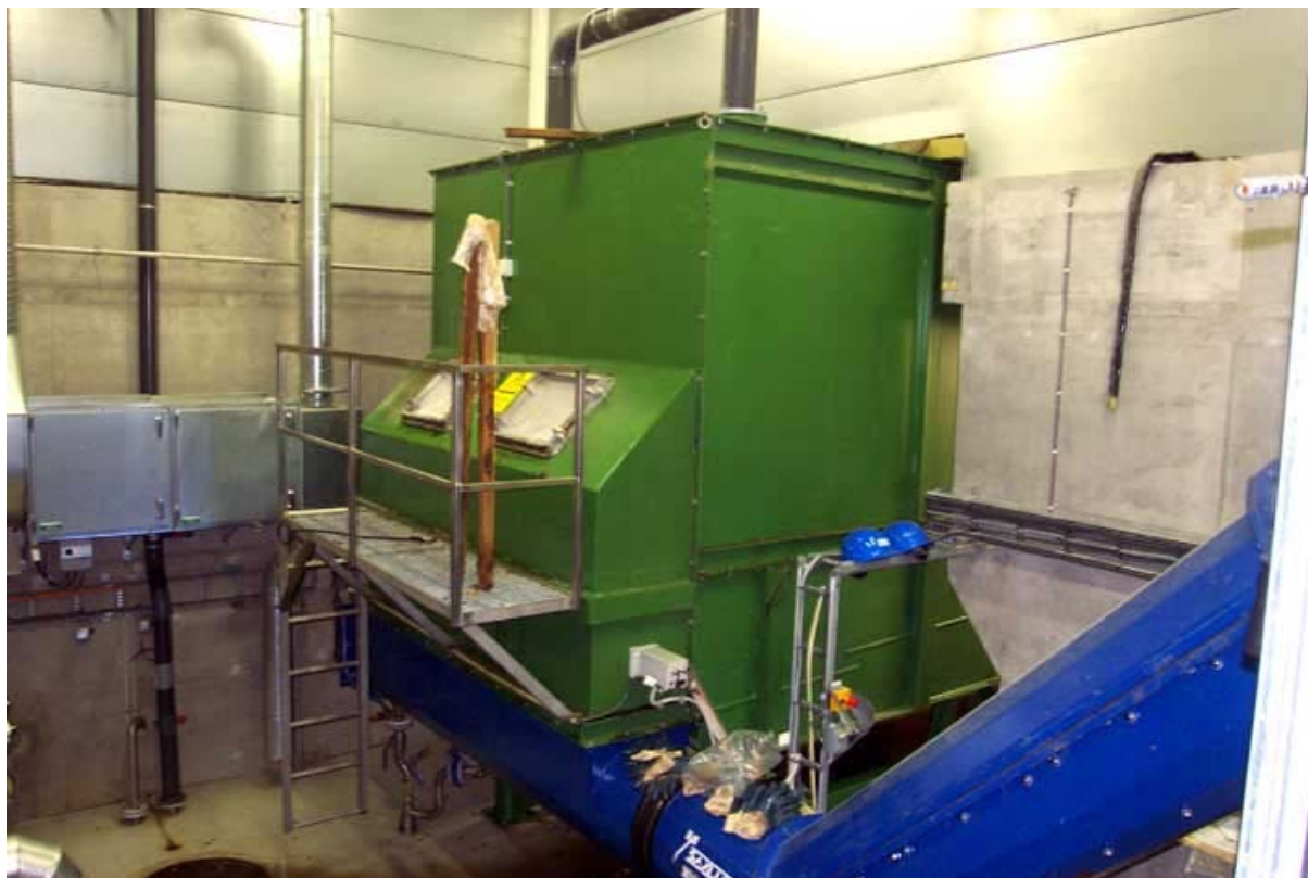
Figur 6. Mottakscontainer med skruetransportør.
